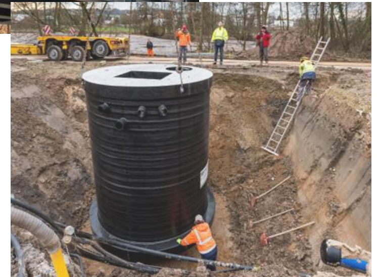
Zwischenbehälter für die Zwischenspeicherung des Flusswassers
